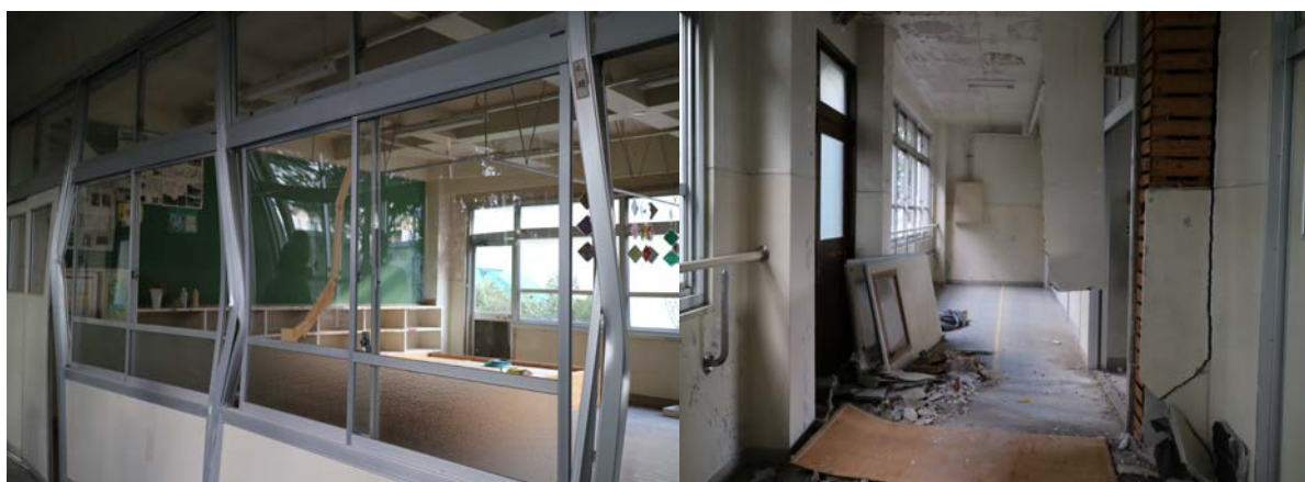
震災で被害を受けた校舎の様子
