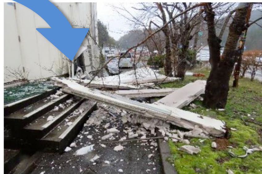
写真 5.6.2. (3)-6 左写真の外壁から落下した ALC パネル (WA-101：輪島市教育施設)
